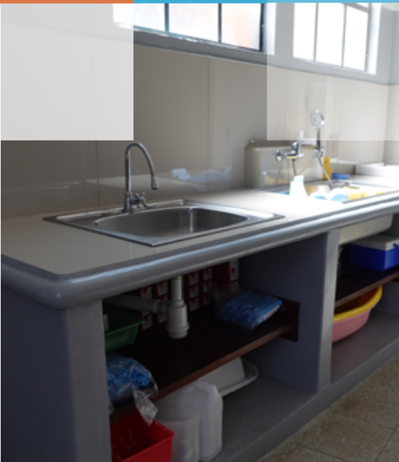
Figura 2: Instalación de lavados por el proyecto de OPS/OMS | Crédito: equipo consultor.
