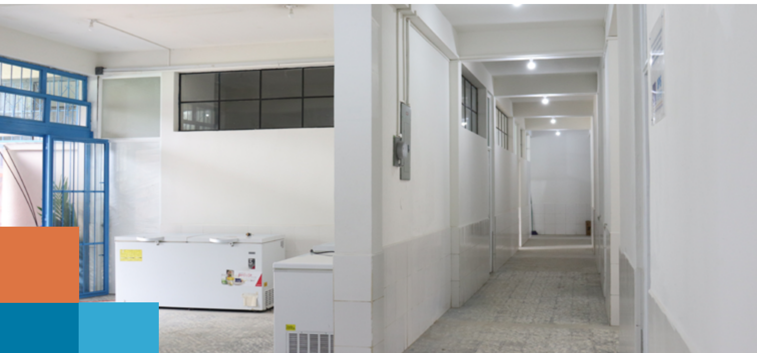
Figura 33: Paredes y ventanales restaurados del Centro de salud Cobán por el proyecto | Crédito: Equipo consultor.
