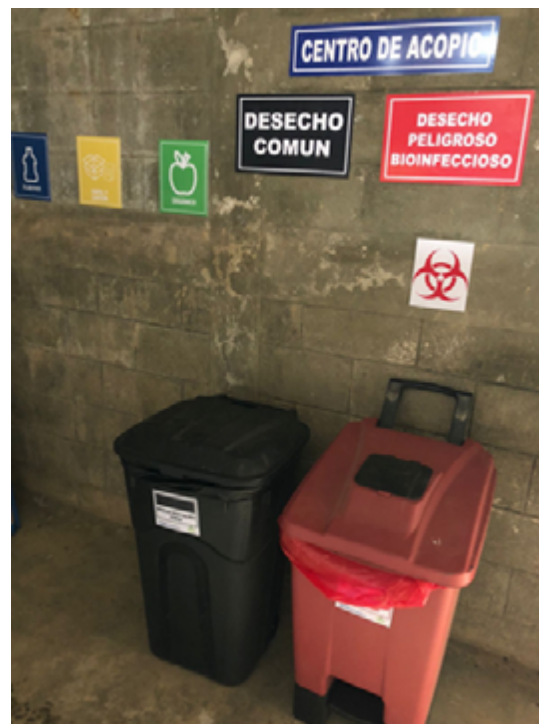
Figura 33: Interior del centro de acopio del Centro comunitario de salud Cimientos Xeputul, con contenedores para el manejo de DSH instalados | Crédito: equipo consultor.
