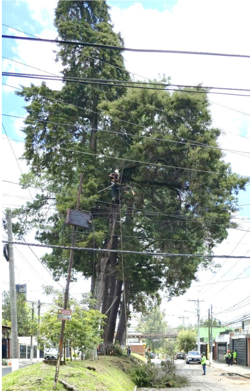
Figura 18. Manejo y poda de árbol urbano de gran porte con antecedentes de deterioro estructural asociado a Ganoderma spp., realizado como medida de mitigación del riesgo en infraestructura y transeúntes.
