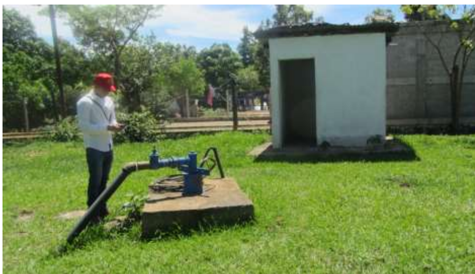
Figura 56. Pozo mecánico municipal Los Filtros en la planta de la aldea Amayo Ingenio.
