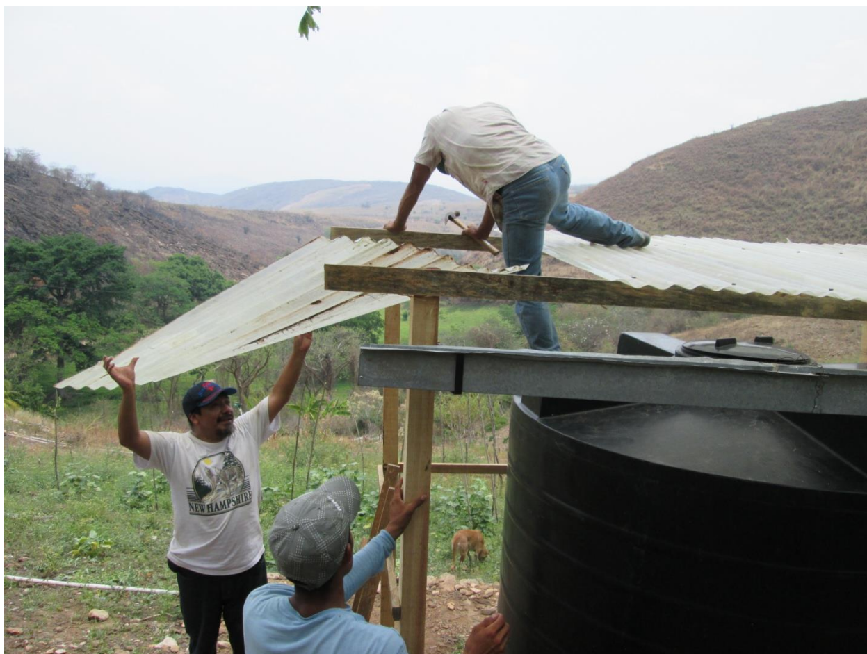
Figura 3. Reparación y mantenimiento de estructuras en el mes de abril de 2014, en la comunidad de, San Luis Buena Vista, San Cristóbal Acasaguastlán, El Progreso.
