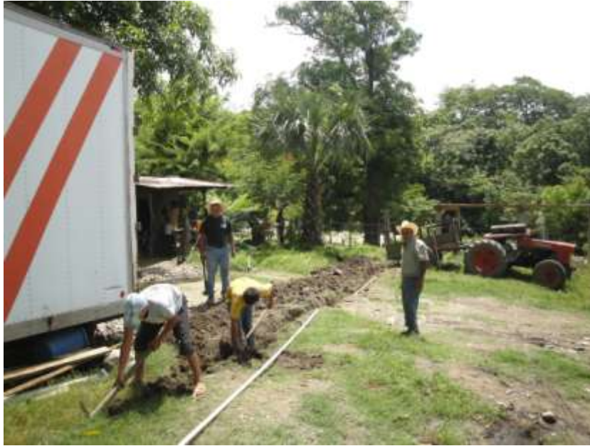
ANEXO. 07. Conducción de la tubería hacia el laboratorio experimental. (Trabajo de campo)
