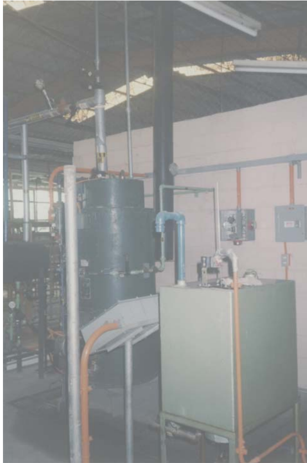
Foto 12. Caldera de Planta Piloto-CII
