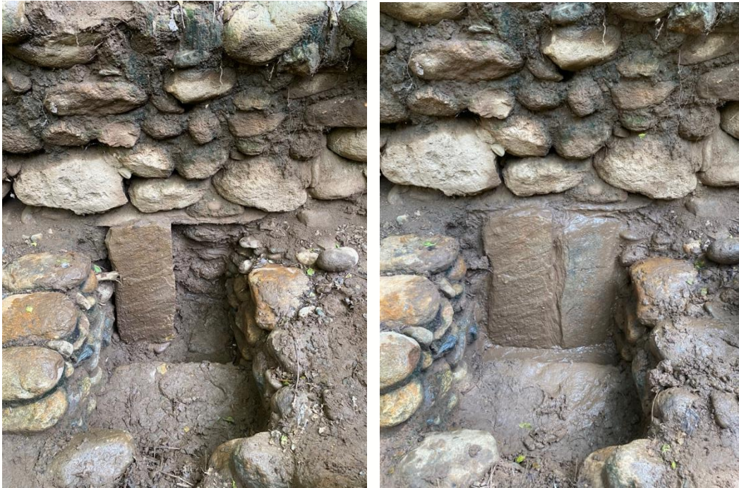
Fig. 44. Finalización del muro de contención dentro de la tumba 10 y debajo del dintel, colocación de las lajas del acceso y consolidación de la entrada de la tumba. Fotografías: M. Garcia, 2024.
