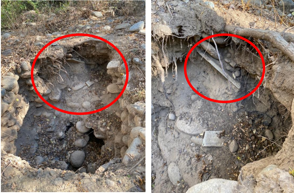
Fig. 37. Diagnóstico de la estructura C1-6 y tumba 10 del sitio arqueológico Vega del Cobán. Izquierda: Muro colapsado de la antecámara de la tumba 10. Derecha: Lajas expuestas por el colapso del muro sur interno. Fotografías: M. Garcia, 2024.
