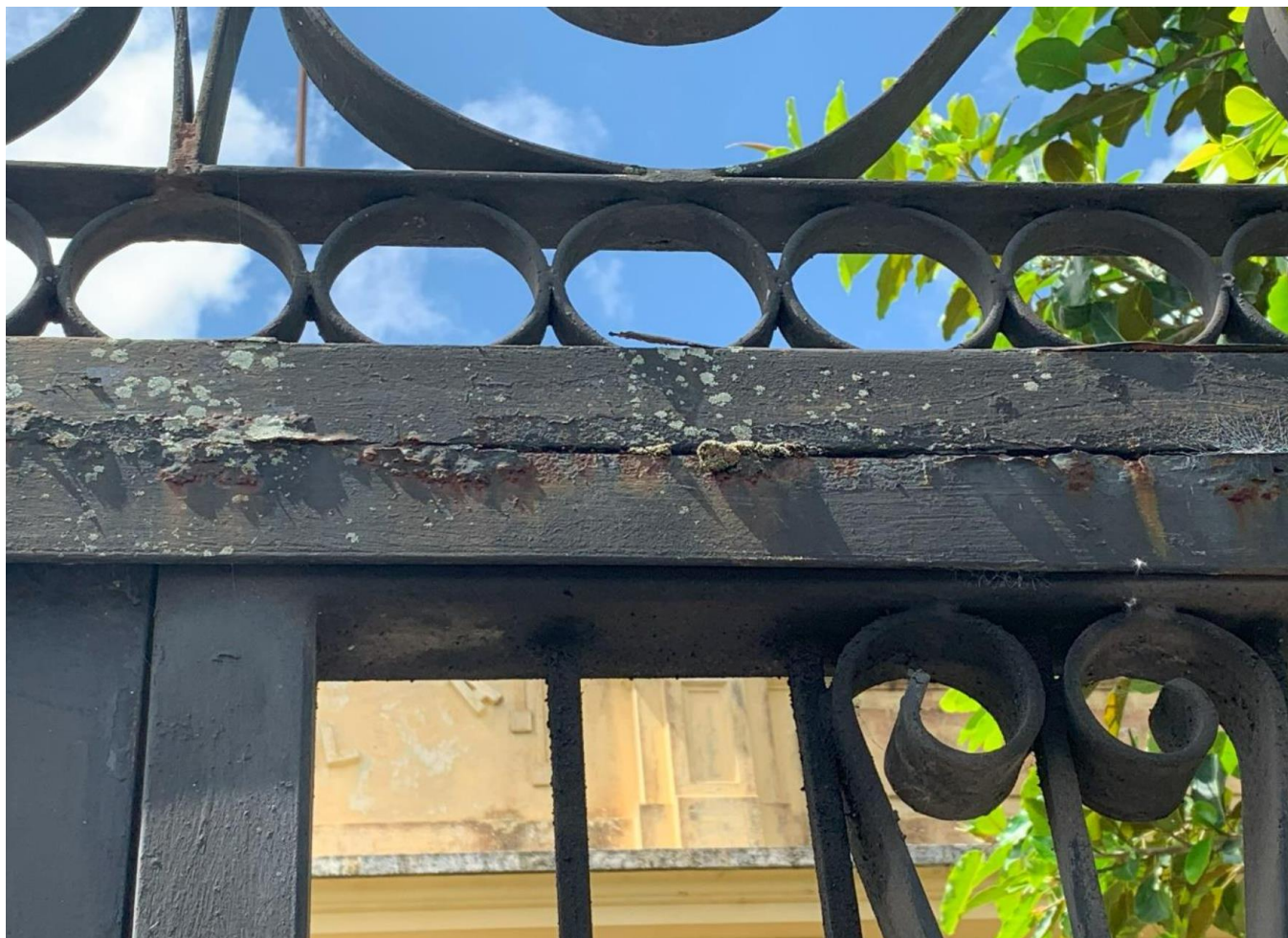
Figura 20: Líquenes sobre estructuras metálicas del Paraninfo Universitario, agosto 2023.
