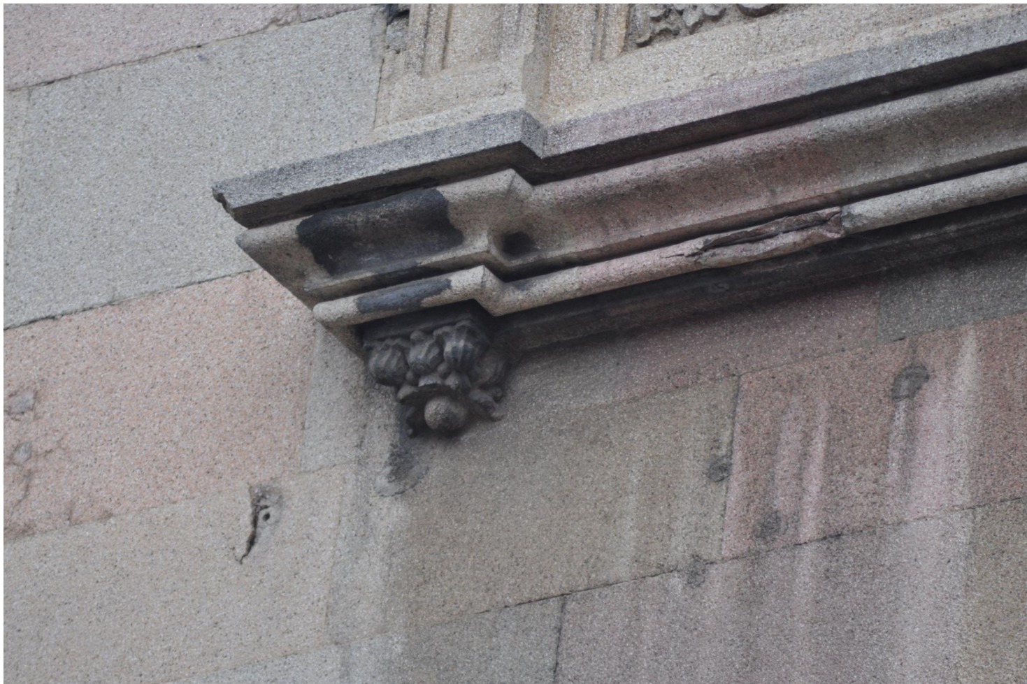
Figura 24: Detalle de ménsula, ventana, fachada sur, Palacio de gobernación, que muestra daños por corrosión, depósitos y lixiviación , agosto 2023.
