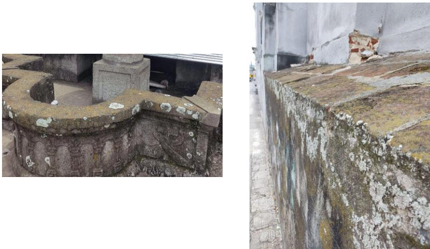
Figura 29: Presencia de líquenes en la Iglesia San Francisco.
