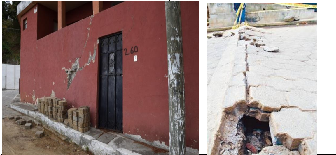
Figura 11. Agrietamientos en viviendas en colonias en Mixco.
