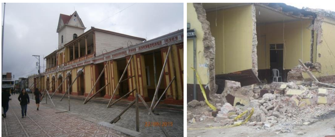
Figura 29. Daños ocasionados por el terremoto. San Pedro Sacatepéquez. San Marcos.
