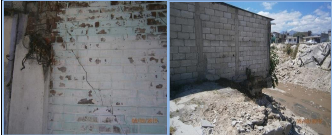
Figura 5. Daños en las orillas del cauce del río Platanitos. Villa Hermosa. San Miguel Petapa.
