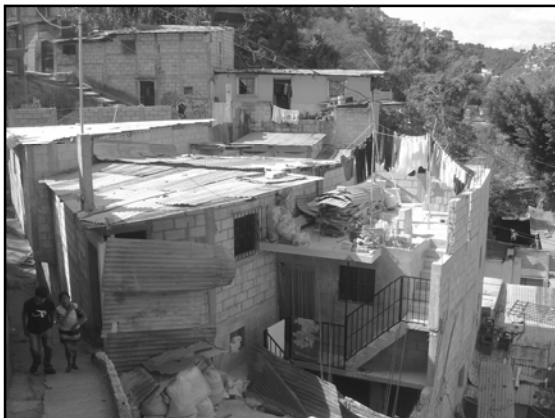
Una foto de la comunidad que permite ver las condiciones de construcción: materiales diversos y pendientes pronunciadas.
