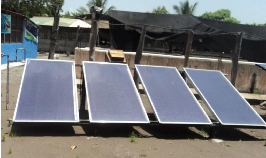
Figura 6. Captadores solares térmicos utilizados en planta a escala.
