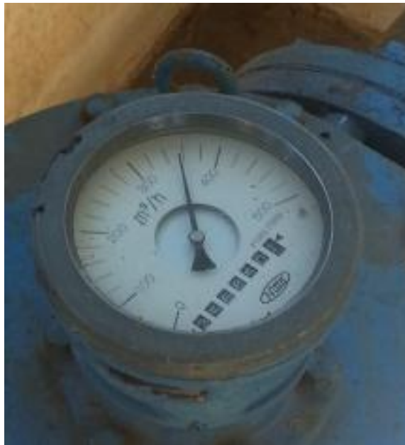
Planta de Agua Jalapa
