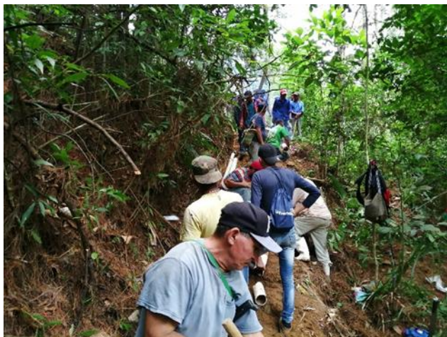
Ilustración 1. Arreglo tuberías. fotografía Giovanni Pacheco.
